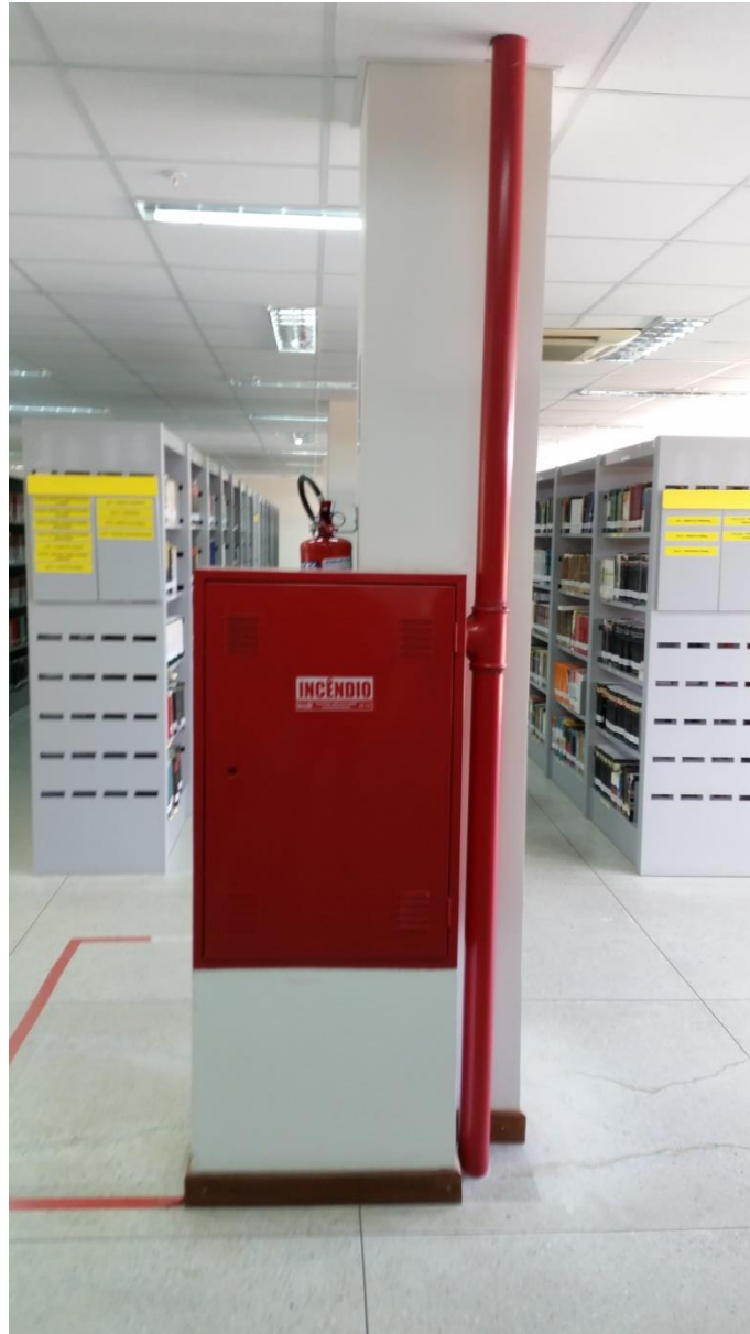
Figura 8 – Extintor de incêndio em pilares
