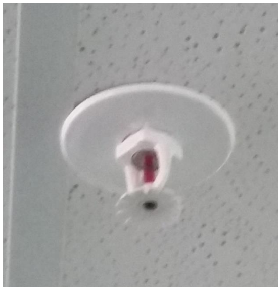
Figura 5 – Modelo de sprinkler do Anexo da Biblioteca Central Zila Mamede
