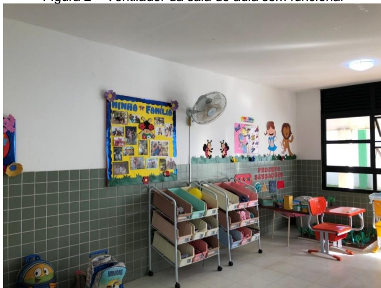
Figura 2 – Ventilador da sala de aula sem funcionar
