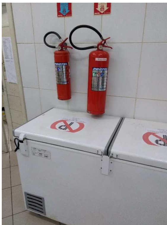
Figura 33: Extintores obstruídos (recepção de gêneros). Fonte: Acervo próprio do autor, 2018
