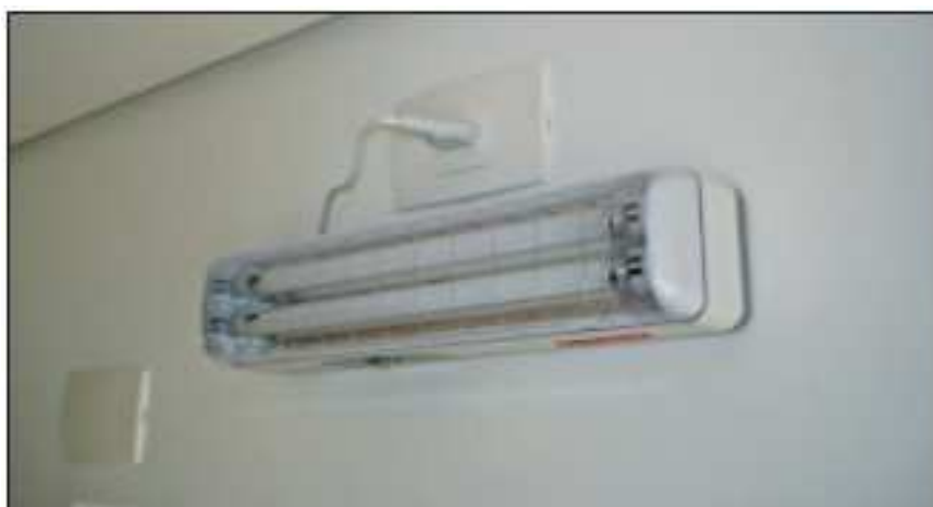
Figura 9: Luminária de aclaramento. Fonte: CBMRN, 2018
