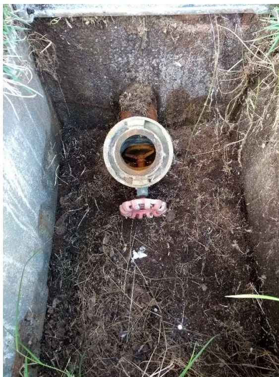
Figura 28: Hidrante de recalque. Fonte: Acervo próprio do autor, 2018
