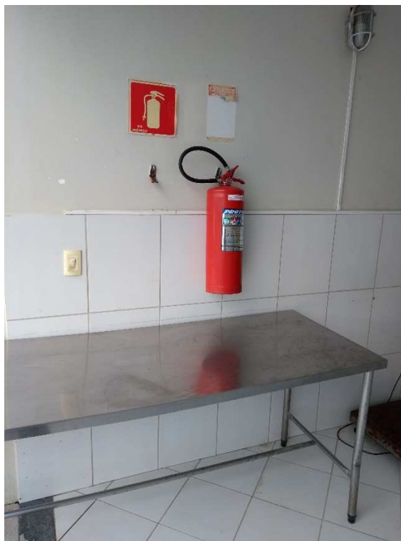
Figura 34: Extintores obstruídos (higienização). Fonte: Acervo próprio do autor, 2018
