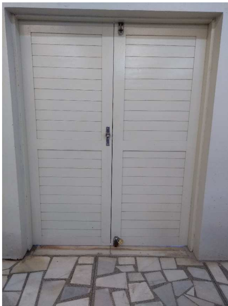
Figura 24: Portas de emergência trancadas e sem barra antipânico. Fonte: Acervo próprio do autor, 2018
