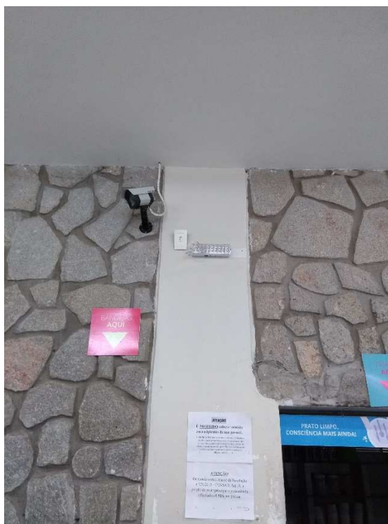
Figura 37: Luminárias desconectadas (refeitório). Fonte: Acervo próprio do autor, 2018
