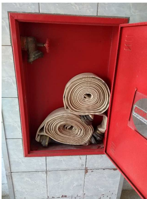
Figura 29: Hidrante nº 2 (pátio de descarga). Fonte: Acervo próprio do autor, 2018
