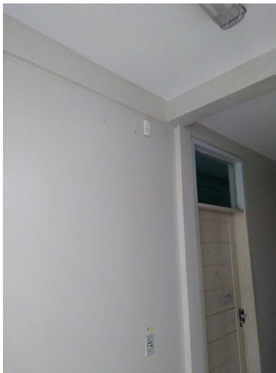
Figura 36: Ausência de luminárias (circulação/jardim). Fonte: Acervo próprio do autor, 2018
