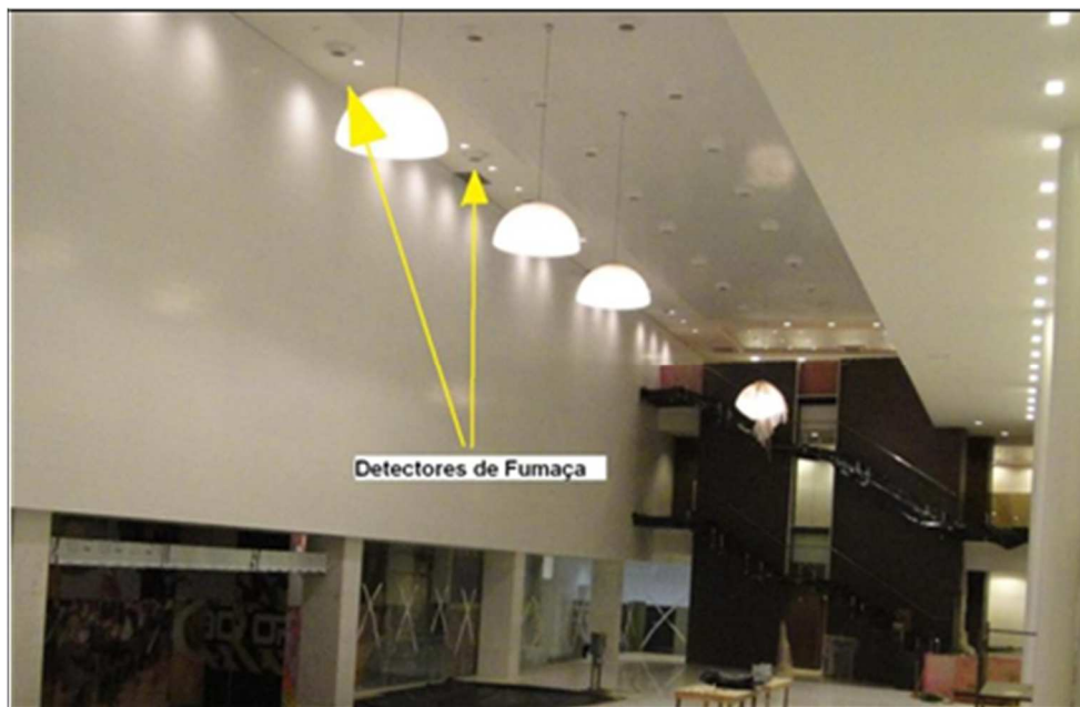
Figura 8: Detectores de fumaça. Fonte: Aquino, 2015, p.40
