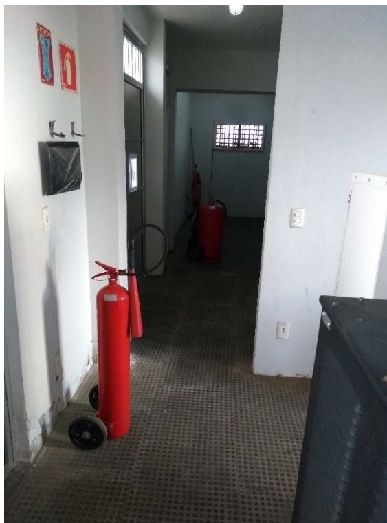
Figura 32: Carretas de CO 2 na central de força elétrica. Fonte: Acervo próprio do autor, 2018
