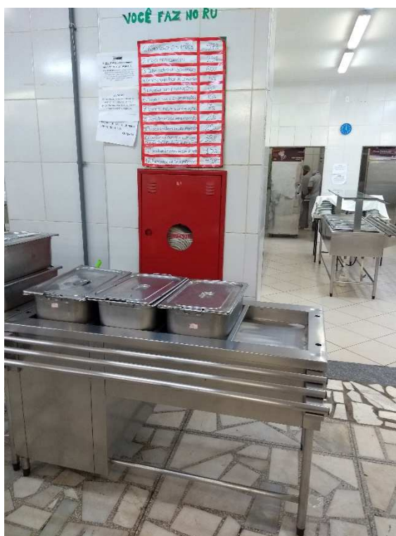
Figura 30: Hidrante nº 4 (refeitório). Fonte: Acervo próprio do autor, 2018
