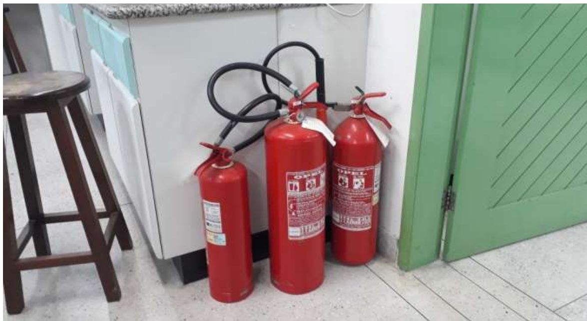
Figura 28: Extintores dispostos de forma inadequada e sem sinalização.
