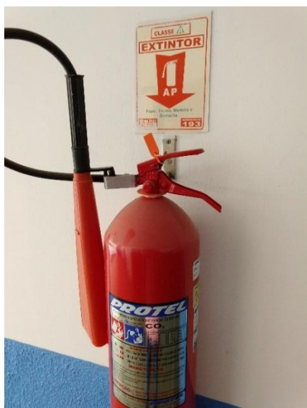
Figura 18: Placa de sinalização incorreta para o extintor. Fonte: Acervo do próprio autor.
