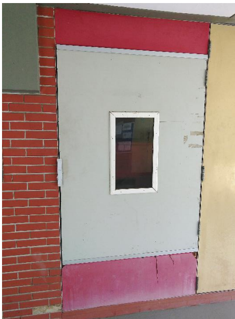
Figura 19: Abrigo de hidrante (fechado) Fonte: Acervo do próprio autor.
