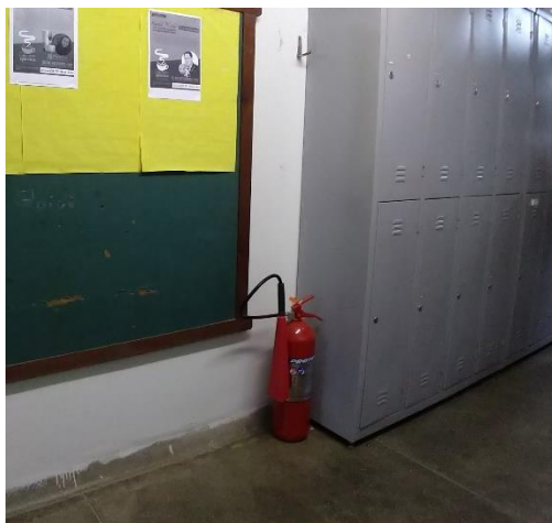
Figura 15: Localização de extintor – central analítica. Fonte: Acervo do próprio autor.
